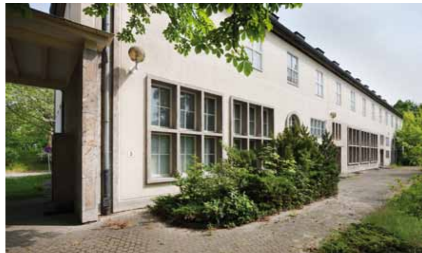
Vorher: Die stark aus der Wandoberfläche heraustretenden Faschen aus Kirchheimer Muschelkalk umrahmen runde und quadratische Kastenfenster an der Südfassade der „The Gallery“.
